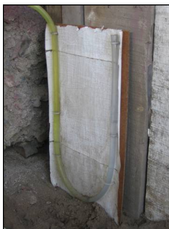
Figura 3.11 – Manòmetre amb la part de la mànega en contacte amb el biogàs esgrogueïda
