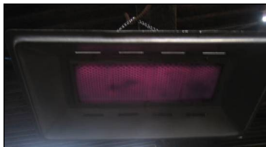
Figura 5.10 - Calefactor radiant operant amb biogàs al Parque Porcino
