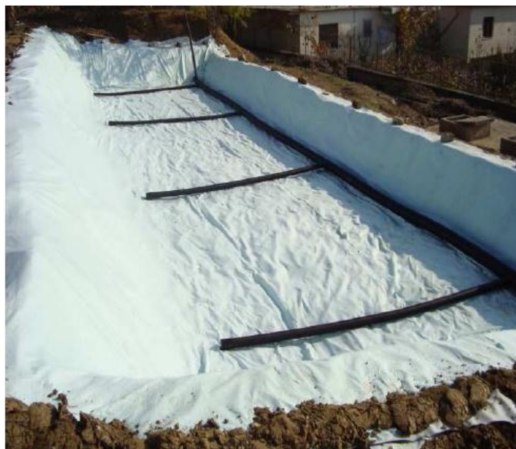
Ilustración 4.2. Tuberías de recolección perforadas y colocadas en la parte inferior del humedal.
