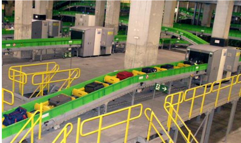
Figura 2.14. Distribución de cintas transportadoras del SATE del aeropuerto de Barcelona-el Prat. (Ver [96])
