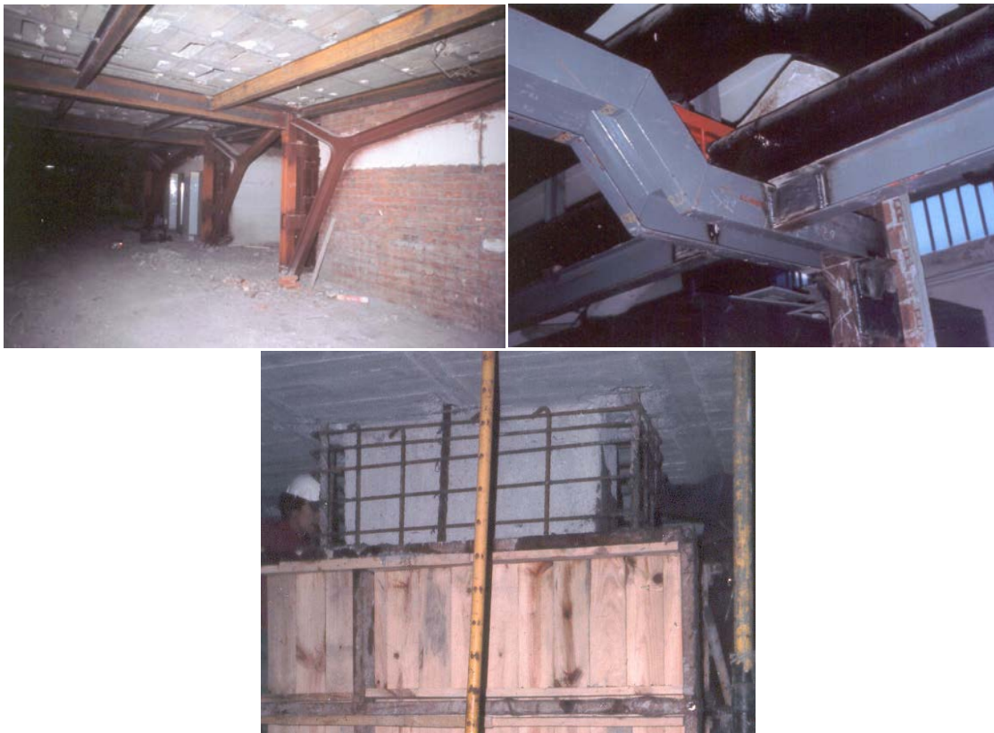
Figura 1.1 Mètodes de reforç estructural convencionals: Addició de perfils metàl·lics (imatges superiors) i encamisat de formigó (imatge inferior) (Francisco Hostalet, 2012)
