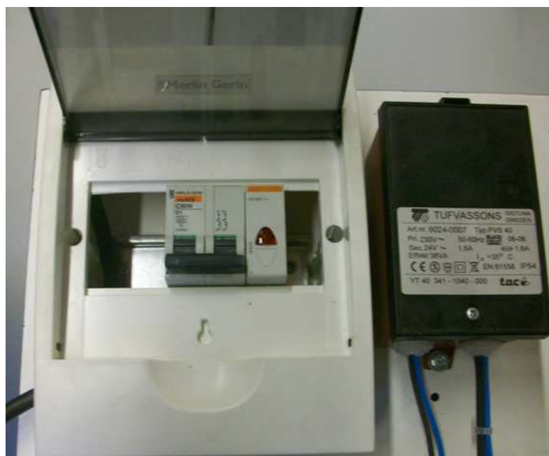
Fig 5.- Limitador de sobretensiones y transformador
