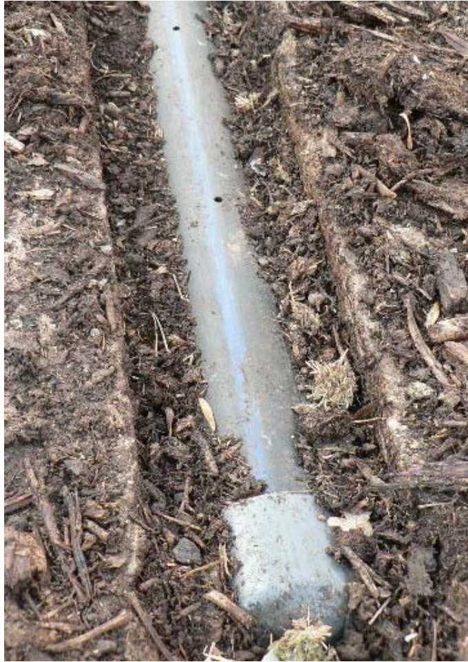
Foto 6. Canonada de polietilè que condueix l'aire fins a la massa en compostatge (Cooperativa La Fageda - Santa Pau). S'hi poden observar els forats per on surt l'aire, que es tapen amb una mínima capa d'estella per evitar que es taponin. En trobar-se la canonada per sota del nivell de la solera, no es veu afectada pel pas de la pala durant les operacions de càrrega i descàrrega. La rasa on està col·locada serveix també per desaiugar els lixiviats.
