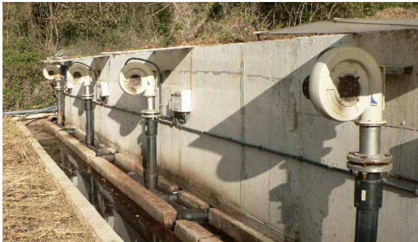
Foto 5. Bateria de ventiladors que injecten l'aire a cada una de les sitges (Cooperativa La Fageda - Santa Pau). S'hi pot observar la canalització que condueix els lixiviats cap a una fossa, des d'on són bombats a la bassa de purins.
