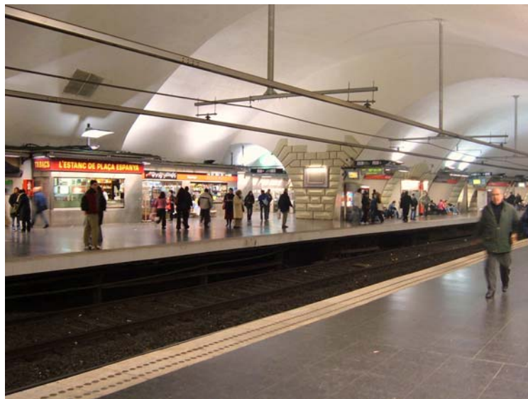
Foto 2.8: Catenaria rígida (estación Plaza España – Barcelona)
