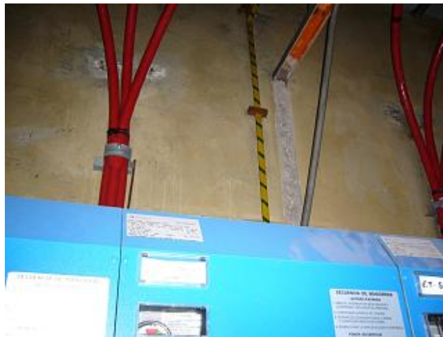
Figura 10.1: Entrada de las celdas de protección (2 acometidas trifásicas)
