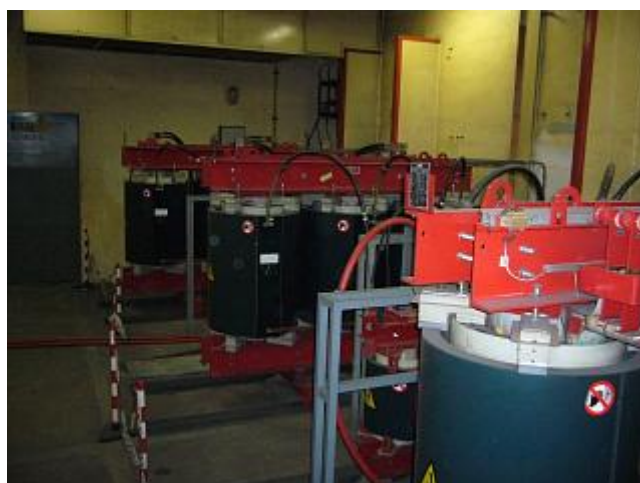
Figura 10.3: Transformadores secos (2 de tracción+2 de servicios auxiliares)
