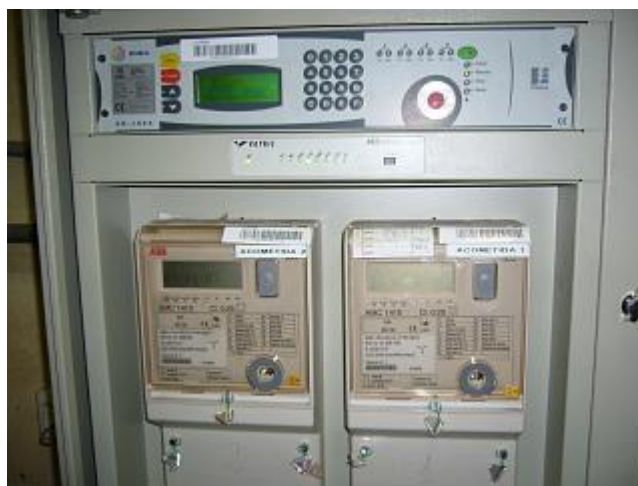
Figura 10.6: Contador de la compañía que suministra la alimentación
