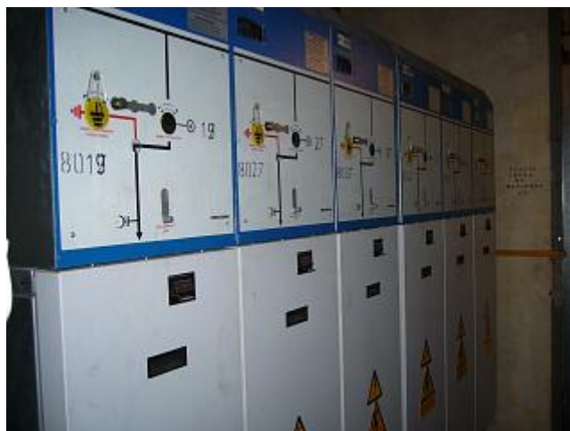
Figura 10.2: Celdas de protección (6 por que 2 acometidas trifásicas)
