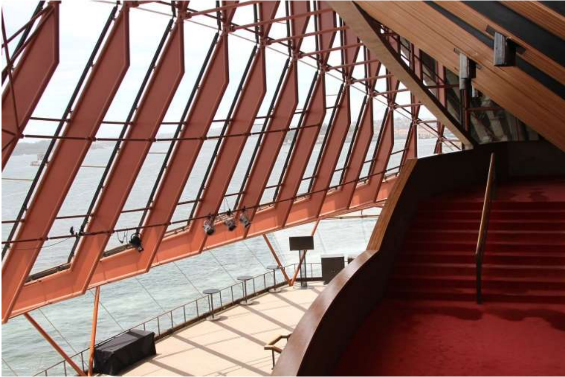
Imagen 58: muro de vidrio donde se pueden ver los parteluces a los que iban ancladas las fijaciones de las piezas de este.
