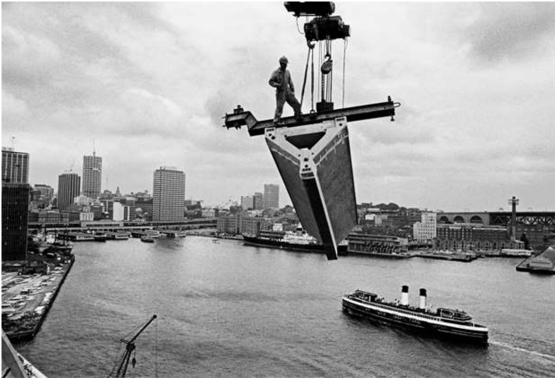
Imagen 50: transporte de una de las múltiples piezas prefabricadas antes de ser colocada en la obra.
