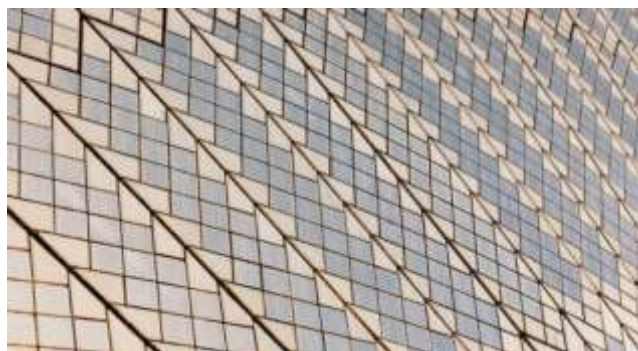
Imagen 54: detalle de las baldosas colocadas donde se aprecia la diferencia de brillo entre las internas y las externas.
