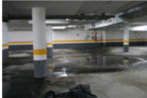
Aparcamiento subterráneo en desuso a causa de problemas de evacuación, gestión y concesión.
