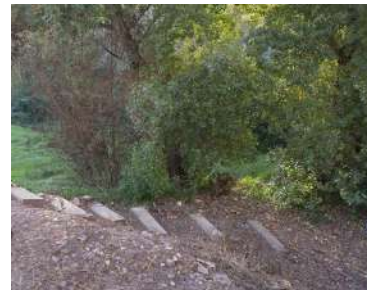
3. Escalles de manteniment inservibles.
