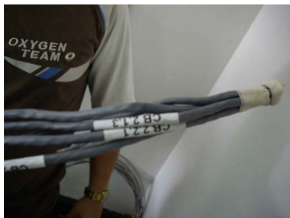
Fig. 1.3 Puño de cables UTPs
