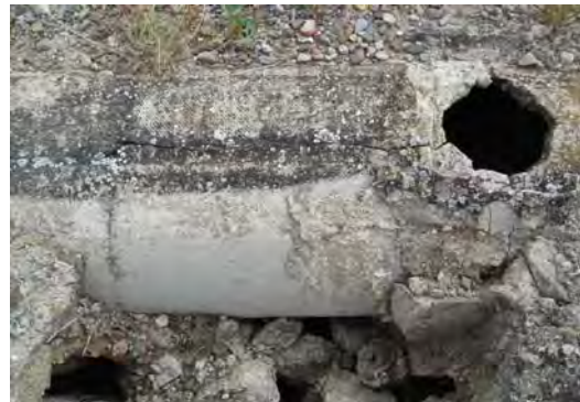
Estado actual de la canalización del puente
