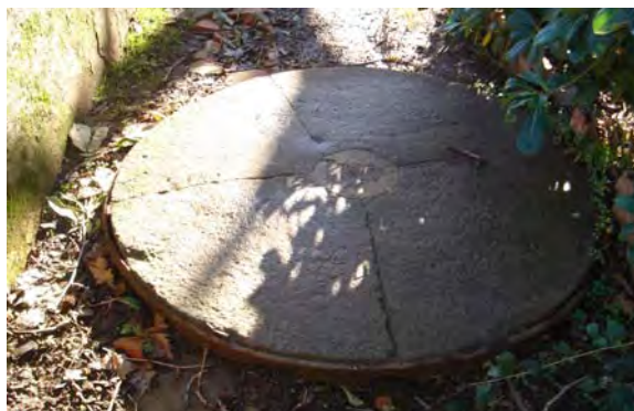
Estado actual de una muela sotana
