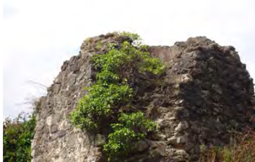
Vista del estado actual del agujero del molino
