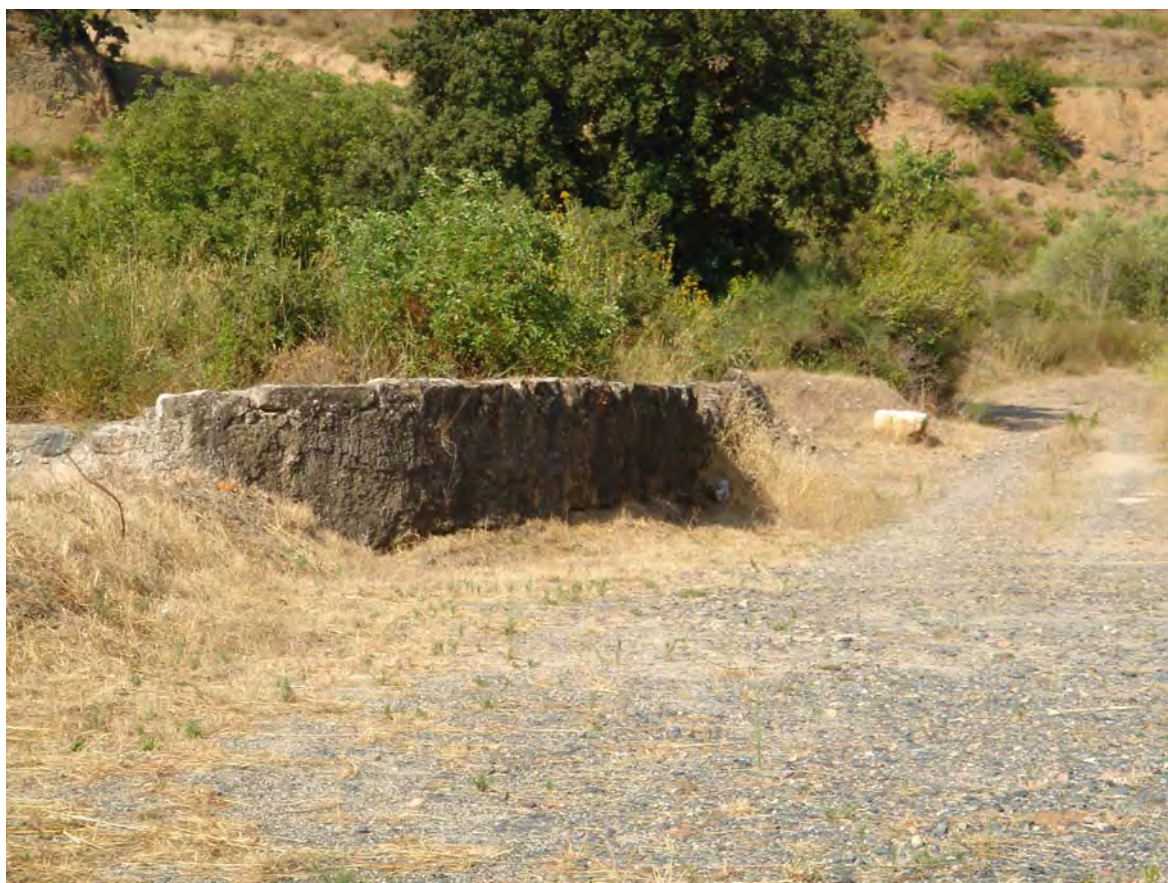
*Parte del muro y canalización del riego, anterior al puente. Camino peatonal adyacente y paralelo al muro.
