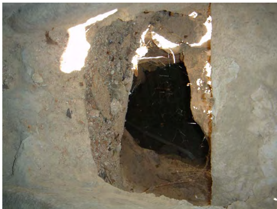
*Huecos en la canalización que se conserva
