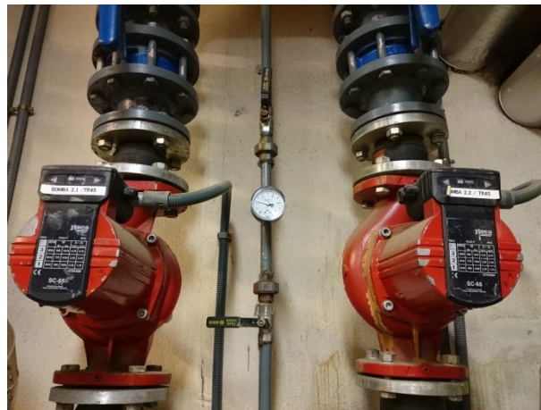
II-lustració 47: Fotografia Bombes Caldera 4 TR5
