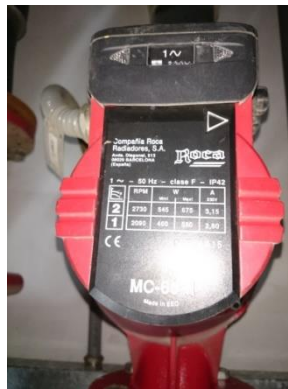
II-lustració 45: Fotografia Bombes Caldera 2 TR4
