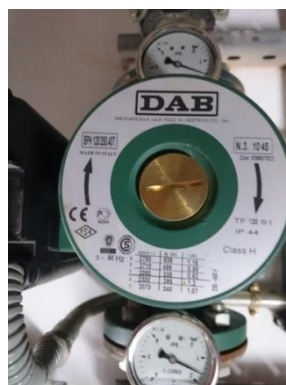
II-lustració 46: Fotografia Bombes Caldera 3 TR4
