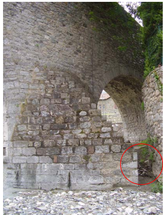
Imagen 2.20 A la izquierda: tajamar con su eficacia reducida al construir el muro de encauzamiento 18
