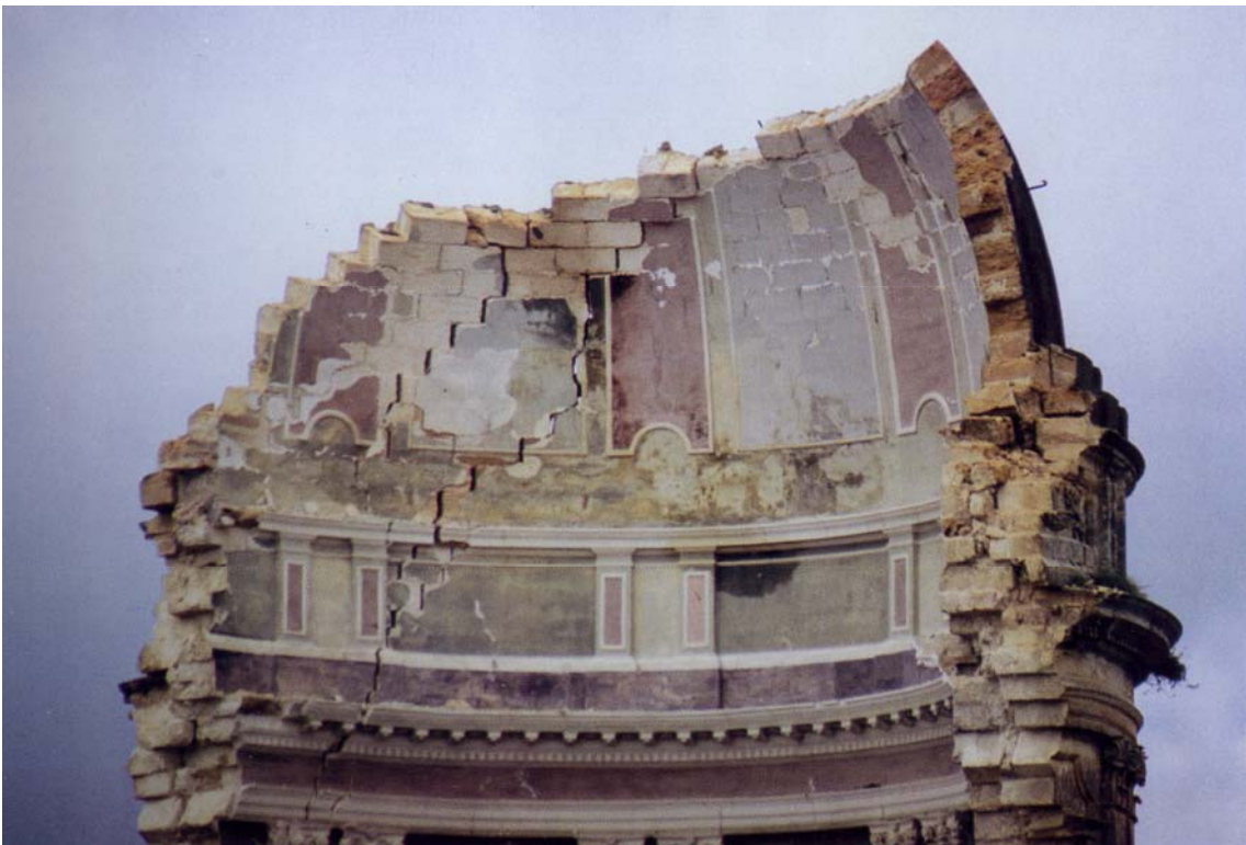
La catedral de Noto després de l'esfondrament del 6 de març de 1996. Noto, Sicília. La ricostruzione della Cattedrale di Noto. Roberto De Benedictis i Salvatore Tringali.
