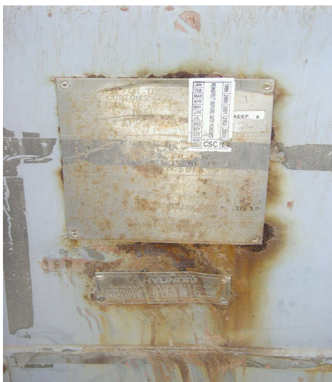
Fotografía nº 24. Placa CSC con puntos de corrosión en la zona de los remaches
