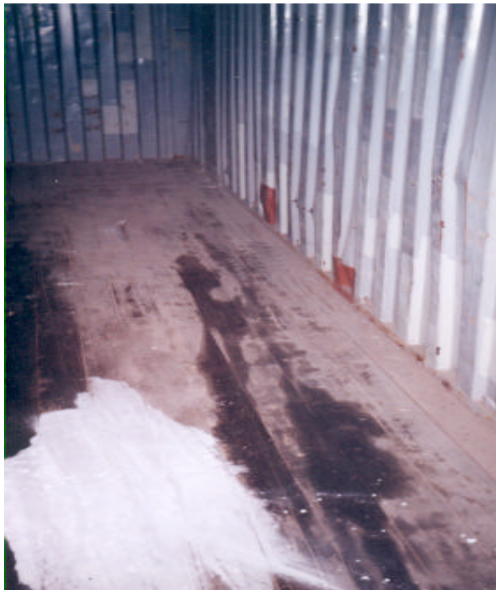
Fotografía nº 25.Suelo de un contenedor con manchas de aceite procedente de una carretilla elevadora
