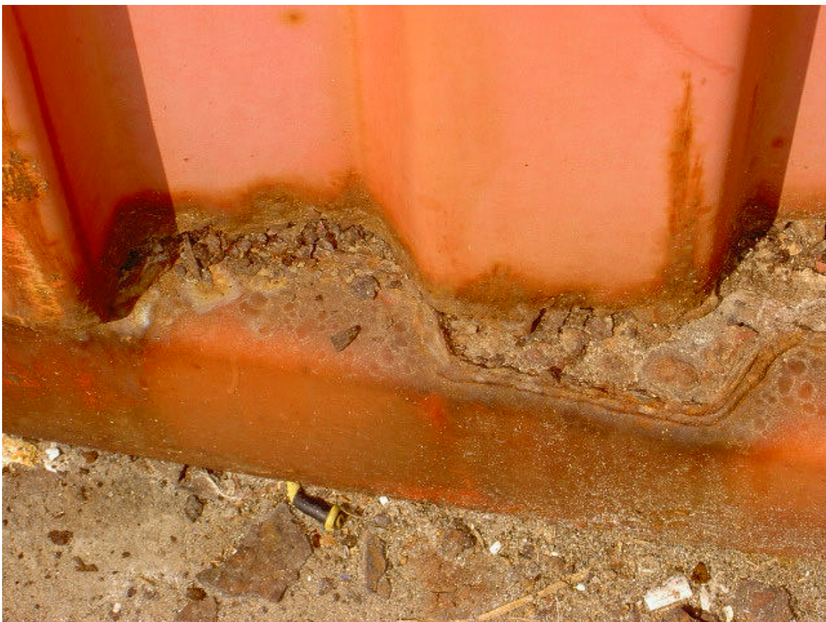
Fotografía nº 23. Corrosión en zona inferior de los paneles laterales
