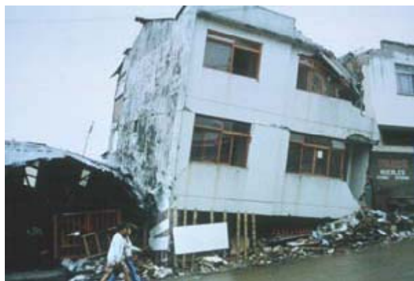
Figura 6.22. Colapso de un edificio de mampostería no reforzada en la ciudad de Armenia - Sismo del Quindío - Colombia.
