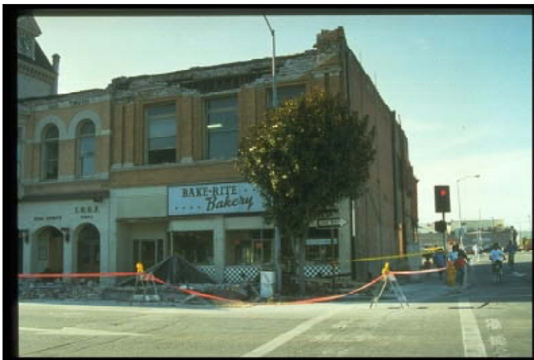
Figura 6.14. Fallo de parapetos en una casa de dos niveles durante el sismo de Loma Prieta ( http://nisee.berkeley.edu ).
