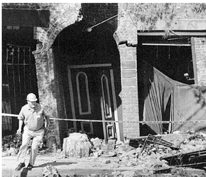
Figura 6.16. Fallo por flexión de las columnas de mampostería no reforzada ("piers") en Santa Cruz - Sismo de Loma Prieta ( http://nisee.berkeley.edu ).
