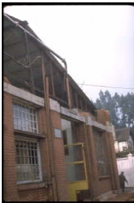
Figura 6.17. Fallo de un muro en la parte superior de un edificio por mala conexión entre el techo y el muro - Sismo de Chile, 25 de Mayo de 1960 ( http://nisee.berkeley.edu ).
