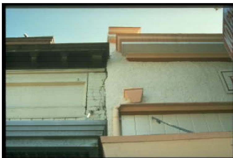
Figura 6.19. Daños producidos por el martilleo entre dos edificios vecinos - Sismo de Loma Prieta ( http://nisee.berkeley.edu ).
