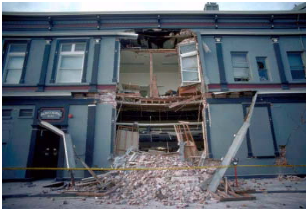
Figura 6.13. Fallo fuera del plano de dos muros de un edificio médico dental en Santa Cruz - Sismo de Loma Prieta ( http://nisee.berkeley.edu ).
