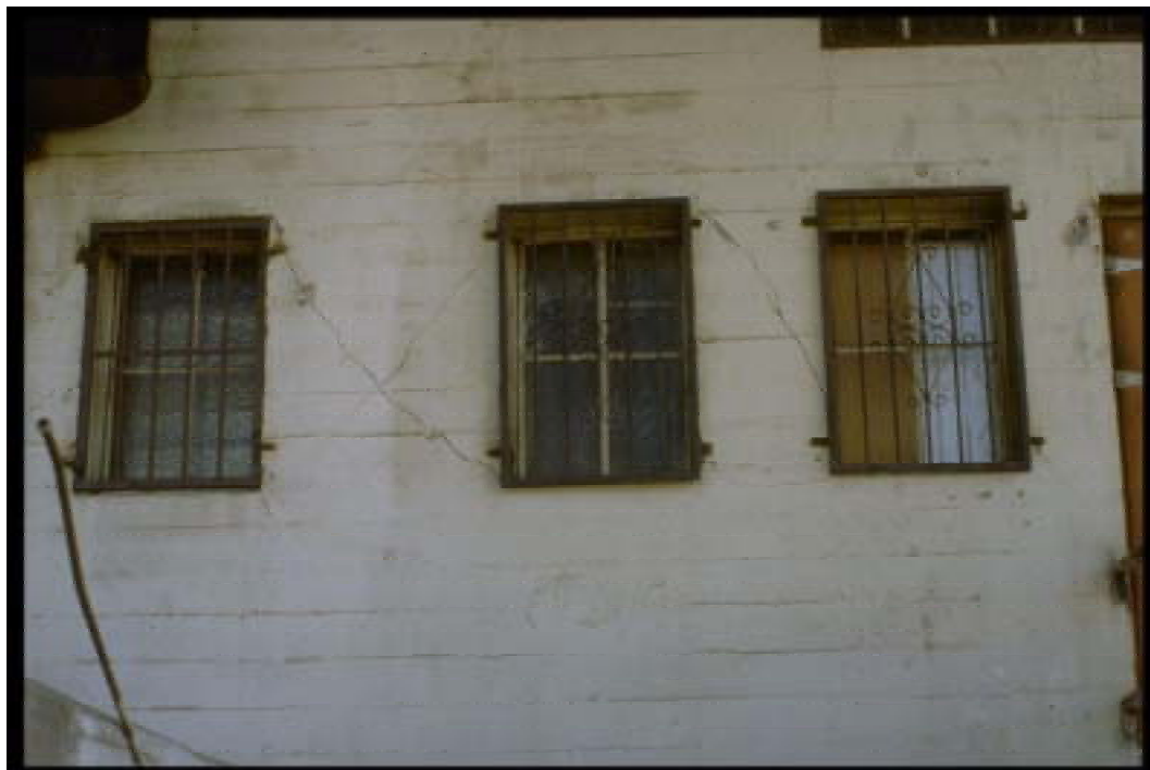
Figura 6.15. Grietas formadas por tensión diagonal entre las ventanas de un edificio de mampostería no reforzada - Sismo de Whittier Narrows, California - Estados Unidos, 1 de Octubre de 1987 ( http://nisee.berkeley.edu ).
