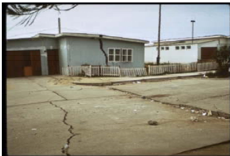
Figura 6.20. Fallo de una casa de mampostería no reforzada por licuefacción del suelo. ( http://nisee.berkeley.edu ). Sismo Chimbote - Perú, 31 de Mayo de 1970. .
