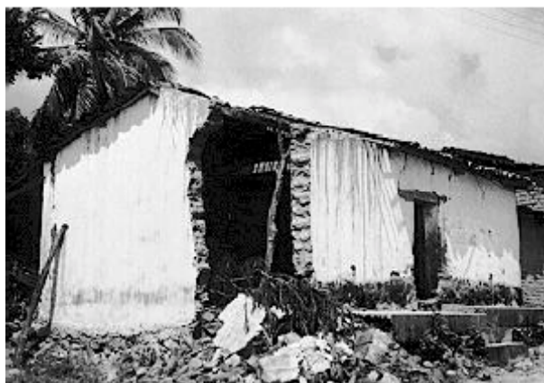
Figura 6.18. Fallo de un muro de adobe debido a conexiones inadecuadas en las esquinas de los muros - Sismo de Guerrero - México, 14 de Septiembre de 1995 (Juárez et al., 2000).
