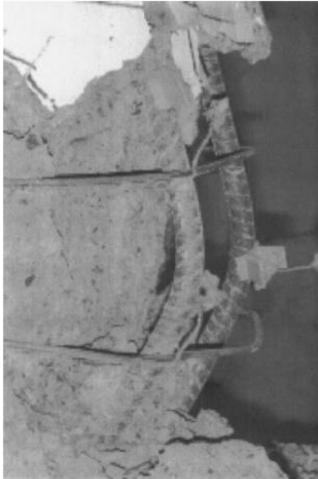
Figura 2.5. Fallo de la barra de hormigón armado por pandeo de las armaduras (Berry y Eberhard 2005)
