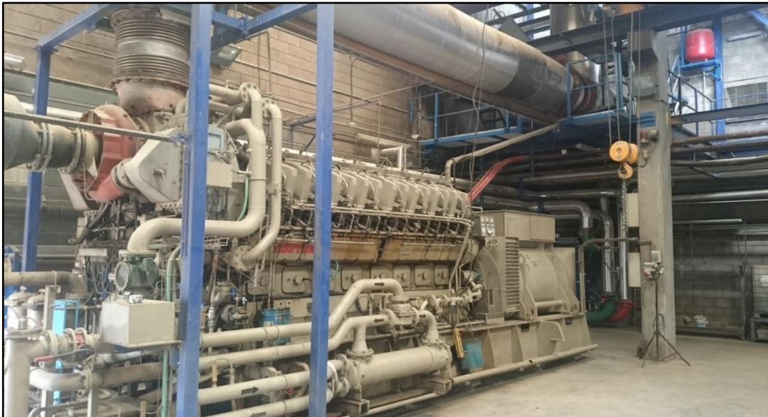
Figura 21. Motor Ruston encarregat de generar energia elèctrica.
