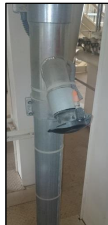
Figura 19 Canalització d'extracció de pols.
