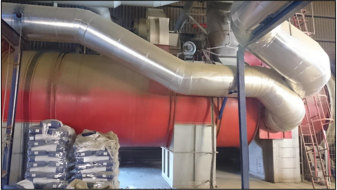
Figura 24. Entrada dels gasos d'escapament a la sortida del cremador.
