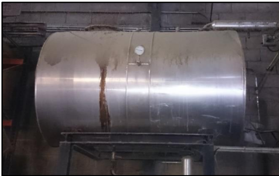
Figura 22. Dipòsit d'emmagatzematge de Fuel Oil pel cremador.
