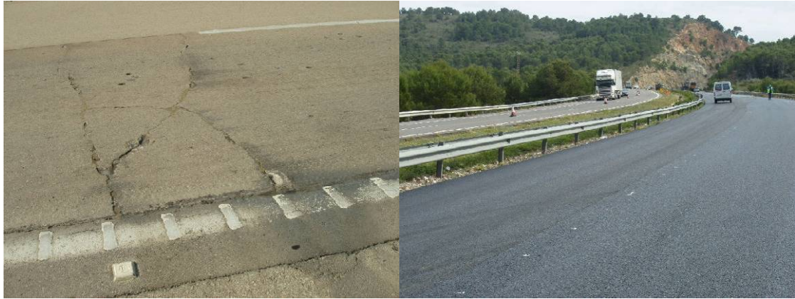
Figura 1. Firme fisurado antes y después del tratamiento con betunes modificados de altas prestaciones.
