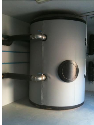
Figura 2.14: Detall dipòsit de 5000 litres per a instal·lació de 350 kW (Foto: Projecte "Boscos del Vallès" CCVOC)
