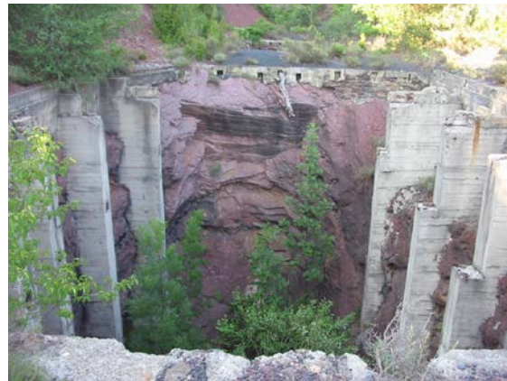
FOTOGRAFIA 4. PARADA 4 Base d'un dels ponts, per on circulava la línia fèrria, que anava de les mines cap a les tremuges. externes Abril 2007
