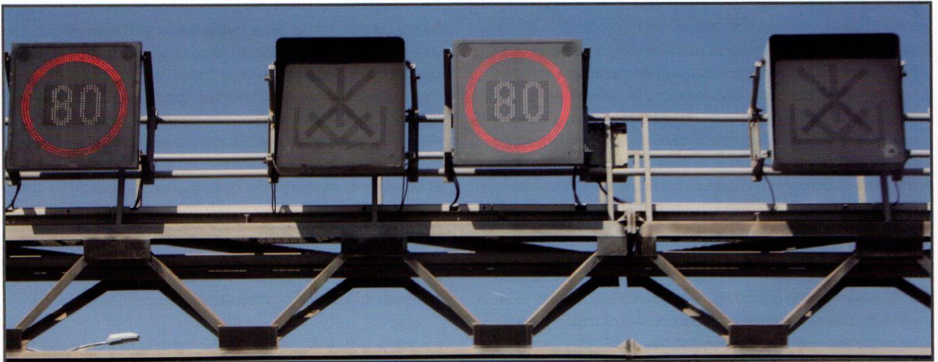
Foto 7. Se produce un incumplimiento generalizado cuando se aplican límites de velocidad por debajo de los máximos permitidos; en esa situación los límites solo se cumplen en las secciones con radar.
