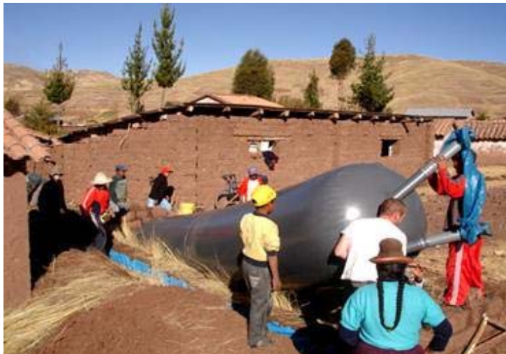
Figura 7. Biodigestor de PVC provisto de doble salida, para el sobrenadante y los sólidos sedimentados
