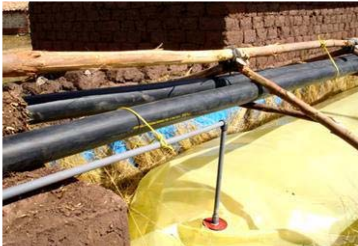
Figura 5. Tuberías para pre-calentar el agua de dilución
