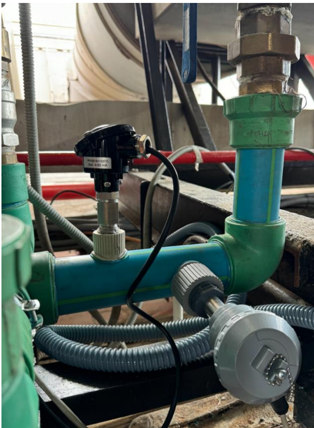
Fig. 1. Instalación real de sondas del sistema ULBIOS.
