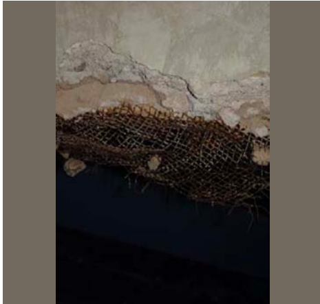
Figura 4. Cielo raso, estratigrafía de fondo a cara superior: malla metálica, cemento natural, capa base estuco cal, capa acabado y pinturas no originales
