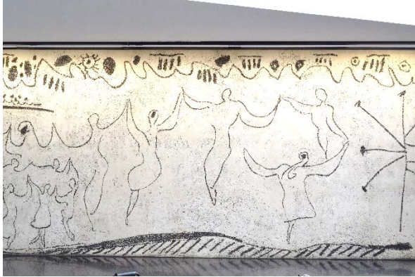
Figura 5: Mural de la Sardana. Fotografía realizada durante los trabajos del estudio diagnóstico.
