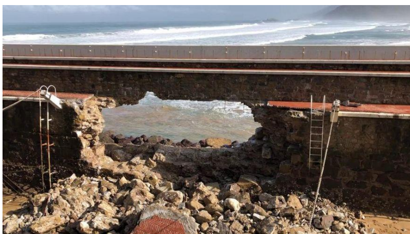
Figura 1.2.2 Daños estructurales. Fuente: noticiasdegipuzkoa.eus
