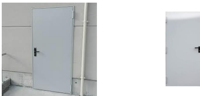
Figura 7.5: Ejemplo puerta cortafuegos par salas técnicas (Fuente: VTL)
