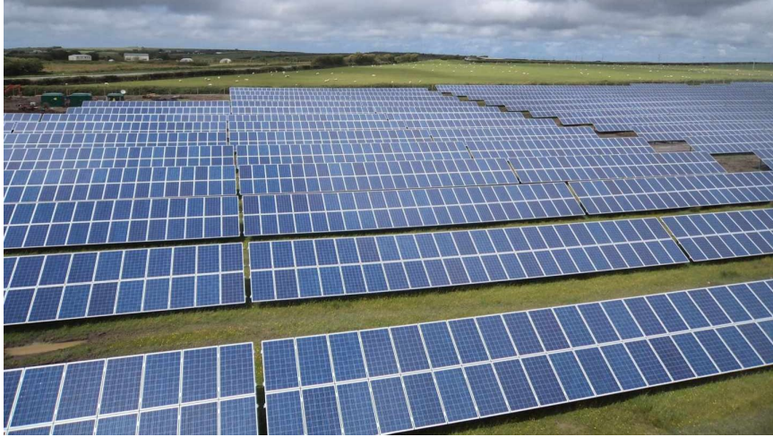
Figura 5: Exemple de MPE (parc fotovoltaic) [5]
