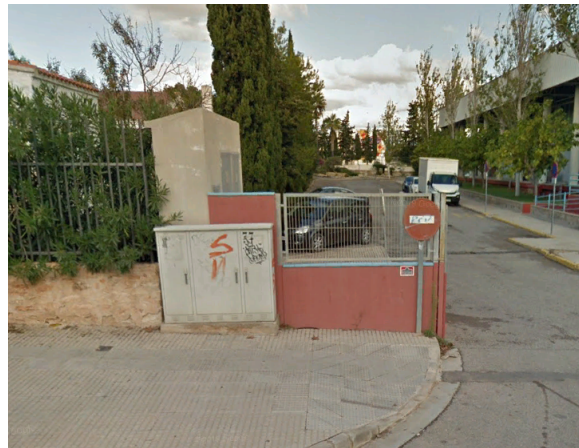
Figura 2: Centralització de contadors existents
