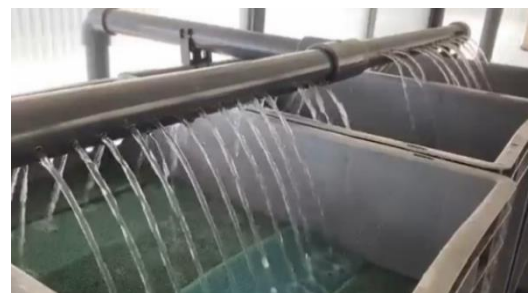
Imagen 3. Caída de agua en el biofiltro
