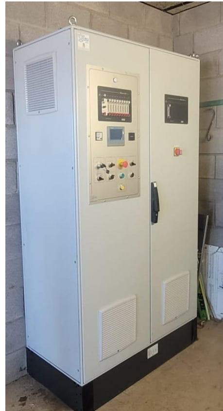
Figura 10 Armari de proteccions i control elèctric actual
