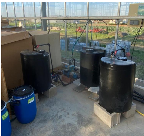
Figura 3-9. Emmagatzematge dels tres tipus d'aigua utilitzada en l'assaig
