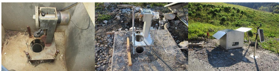
Figura 8. Izda.: Equipo de extensómetro de cable+piezómetro SE-01. Centro: Nuevo equipo de extensómetro de cable+piezómetro SE-02. Dcha.: Caseta protección equipo SE-03
