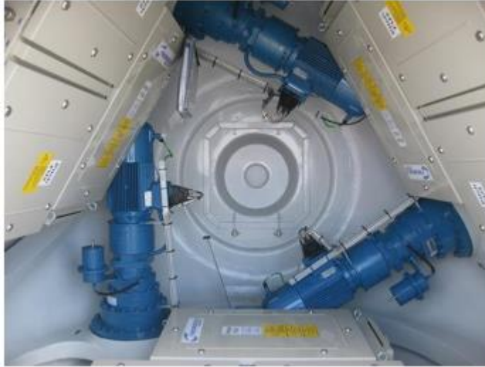
Figura 5.20. Detall dels tres motors elèctrics que actuen sobre l'angle de Pitch
