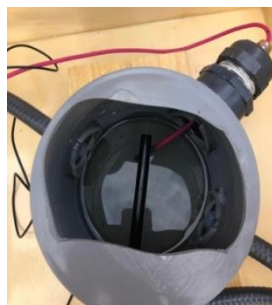
Figura 10. Trencament del cilindre de la caixa multiparamètrica degut a un incorrecte funcionament de la purga d'aire i l'explosió per augment de pressió dins el circuit.
