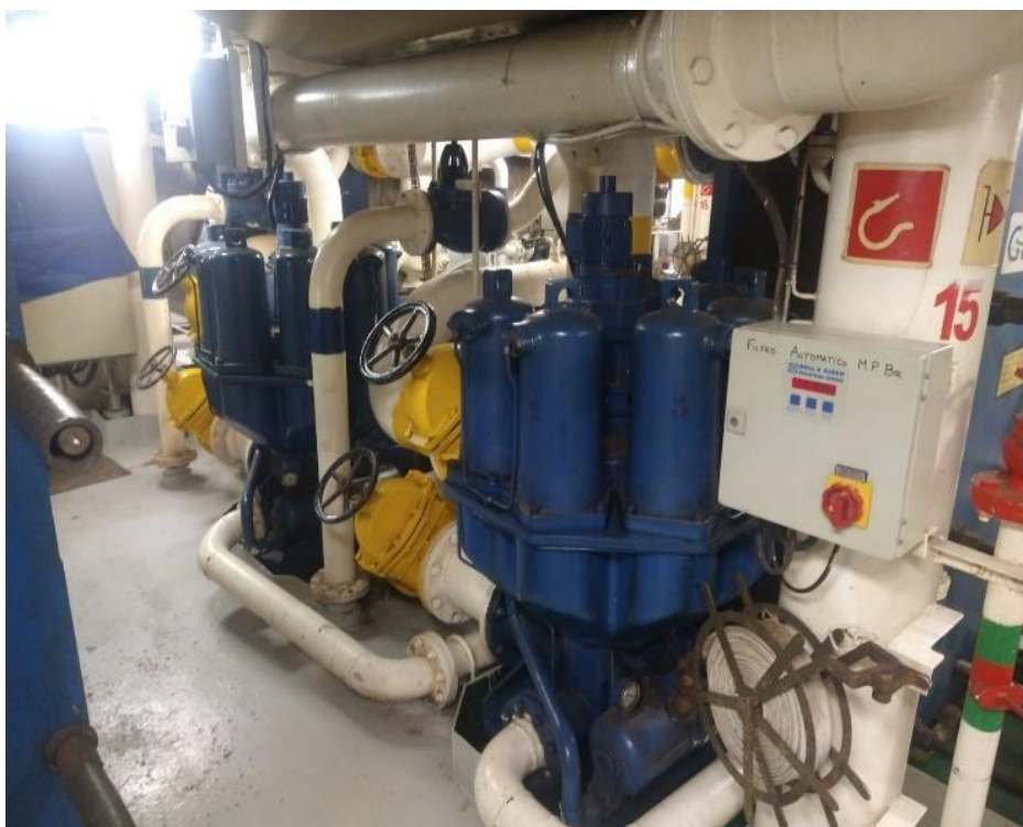
Figura 22: Dos unidades de filtros automáticos de aceite – Fuente: Buque real
