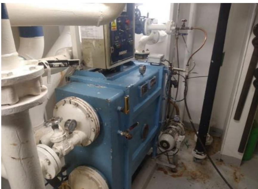
Figura 10: Generador de agua dulce – Fuente: Buque real
