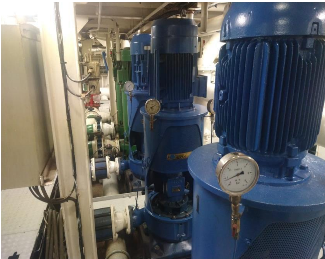
Figura 6: Bombas de agua dulce de baja temperatura y bombas de agua salada – Fuente: Buque real
