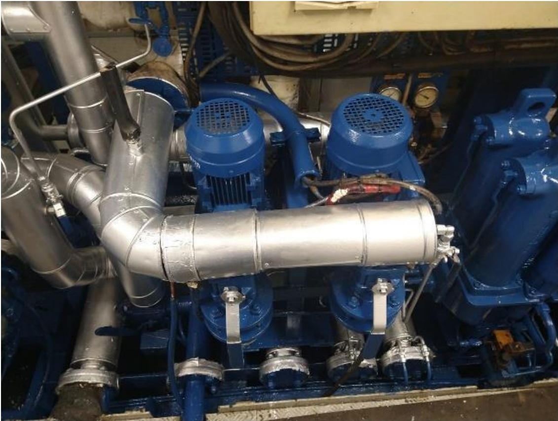
Figura 13: Bomba BOOSTER – Fuente: Buque real
