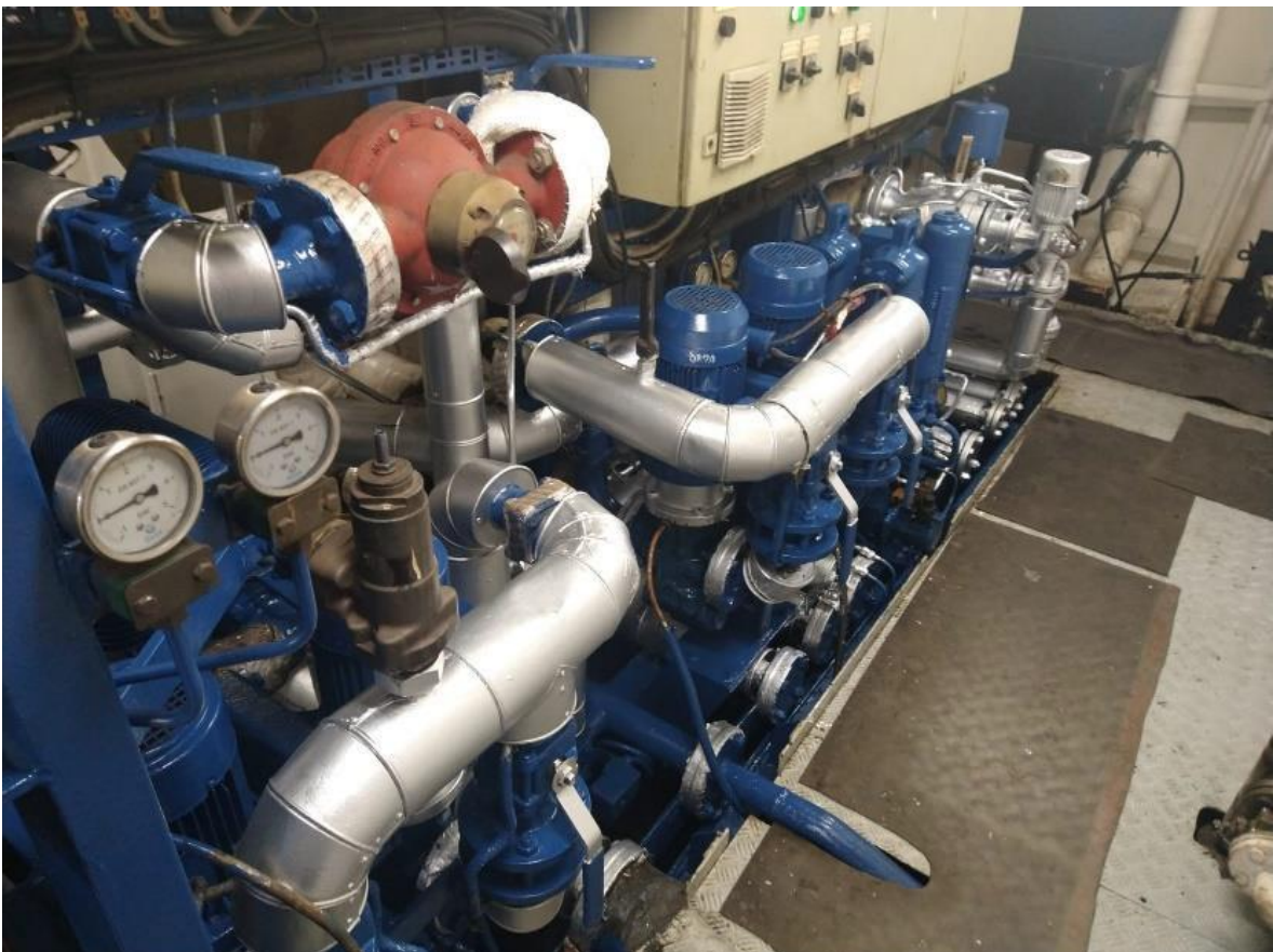
Figura 11: Vista general del módulo de combustible – Fuente: Buque real
