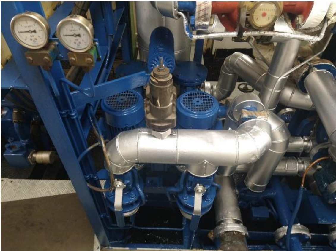
Figura 14: Bomba FEEDER – Fuente: Buque real
