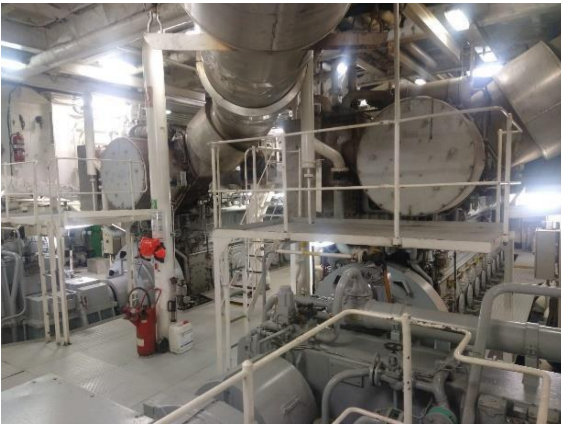
Figura 17: Vista general del motor principal de babor y estribor – Fuente: Buque real
