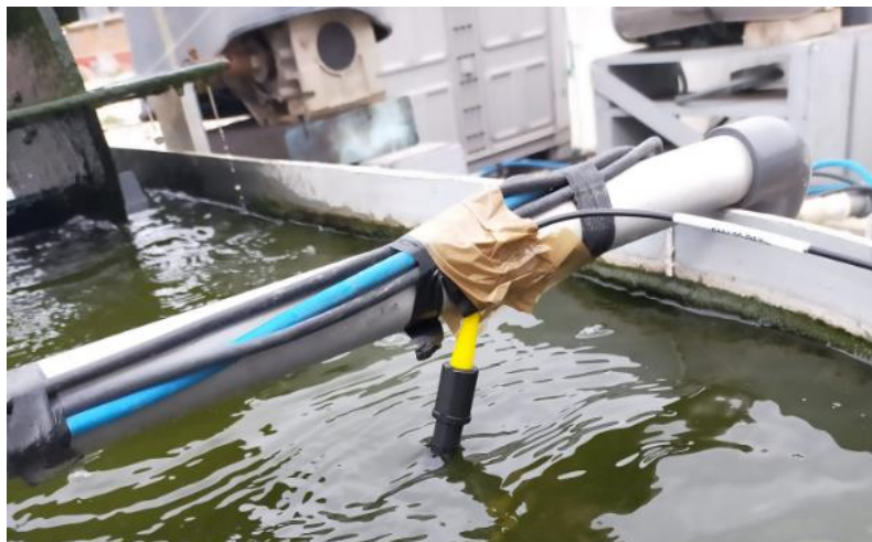
Imatge 82. Sensor de oxigen dissolta instal·lat a les HRAP. Font: Pròpia.
