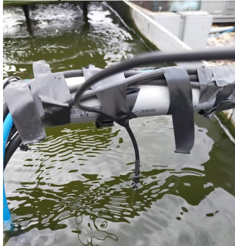
Imatge 83. Sensor de temperatura instal·lat a les HRAP. Font: Pròpia.
