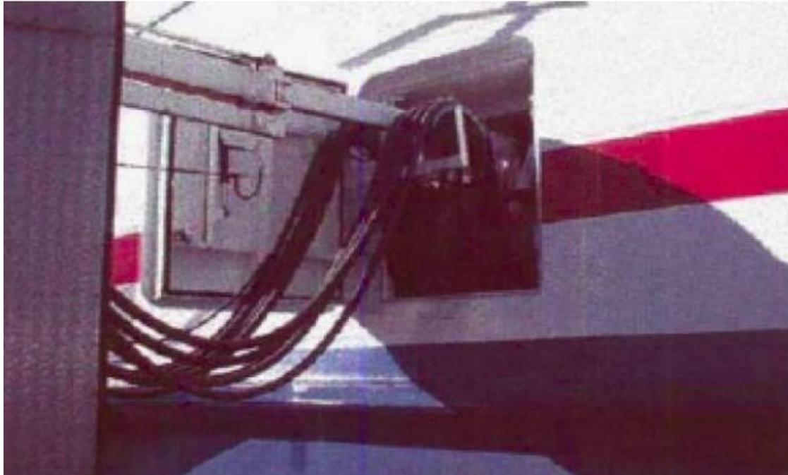
Figura 2 Conexión eléctrica desde tierra puerto de Gotemburgo en 1989. Fuente: Chalmers
