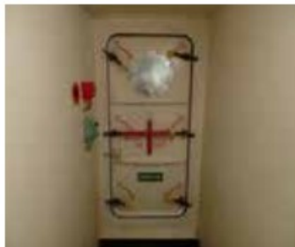
Figura 27: Puerta de acero que evita acceso no autorizados. Fuente BMP5
