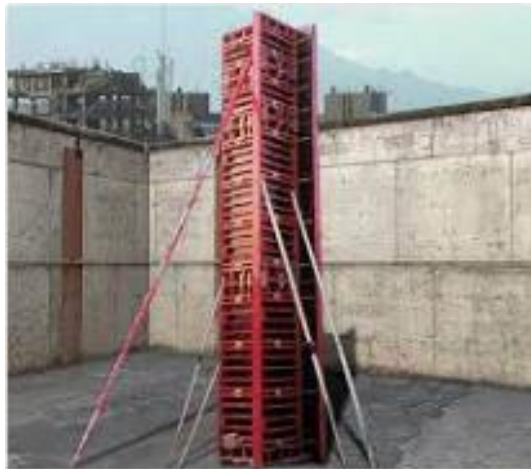
Figura 32: Imatge d'un encofrat d'un pilar que conté formigó armat. (Font: "Generador de preus" [19])
