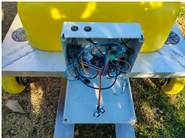
Ilustración 50.- Caja de conexiones. [Fuente Propia]
