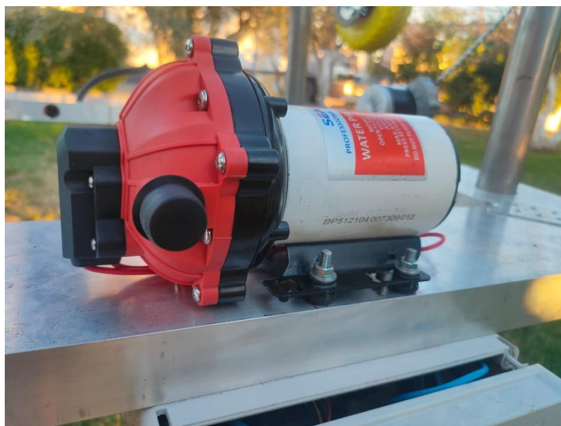
Ilustración 49.- Bomba bajo estructura. [Fuente Propia]
