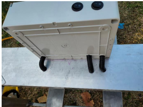
Ilustración 51.- Corrugados de cableado. [Fuente Propia]
