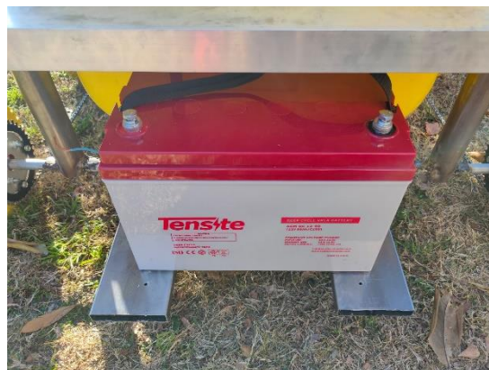
Ilustración 48.- Ubicación de la batería. [Fuente Propia]
