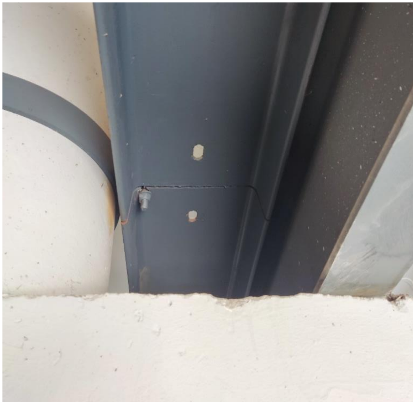
Figura 12. Defecto en conexión viga carrilera-pilar.
