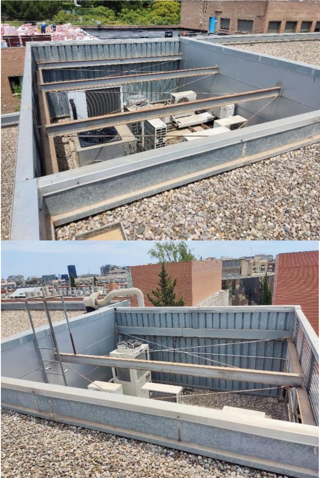
Figura 17. Maquinaria presente en la cubierta.
