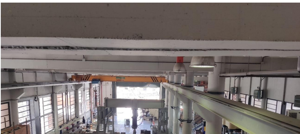
Figura 6. Viga flectada en el eje 13
