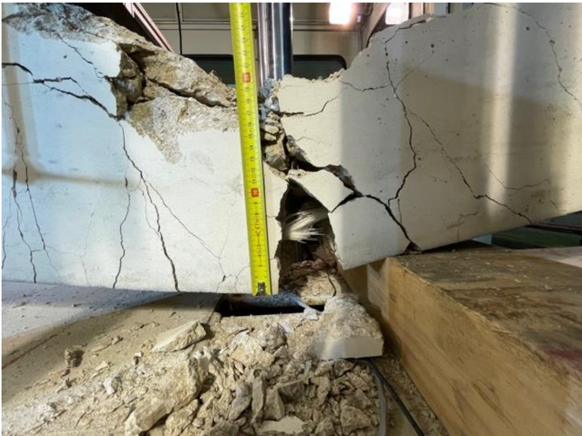
Figura 76. Situación de la armadura en la viga 2V13 después de rotura.
