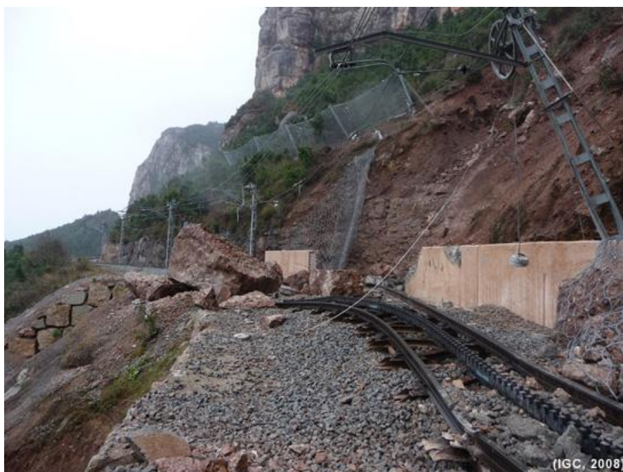
Figura 1. Desprendimiento de rocas en el Cremallera de Montserrat (Pagina web ICGC, Consulta 2021)
