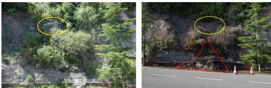
Figura 28. Desprendimiento aparcamiento Montserrat de calidad media (Nota técnica visita del seguimiento geológico de la Montaña de Montserrat, 2020, ICGC)
