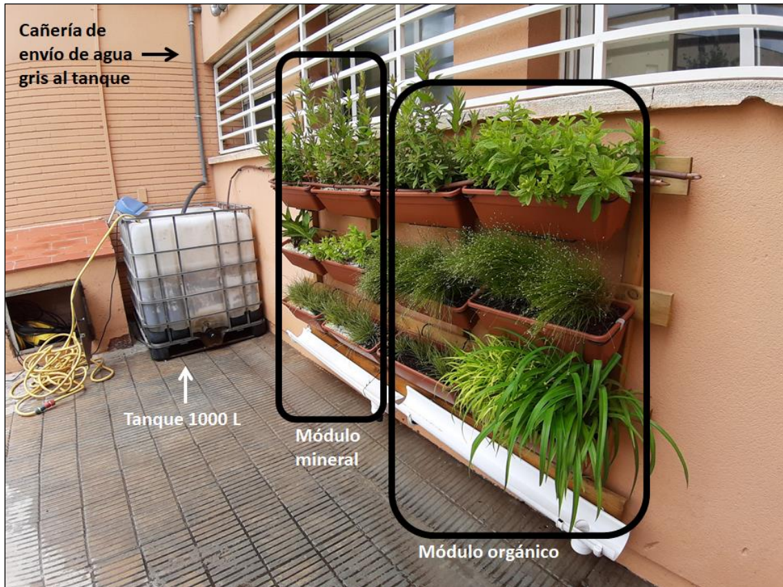
Figura 12. Sistema piloto implementado en el Institut Les Salines para el tratamiento de agua gris
