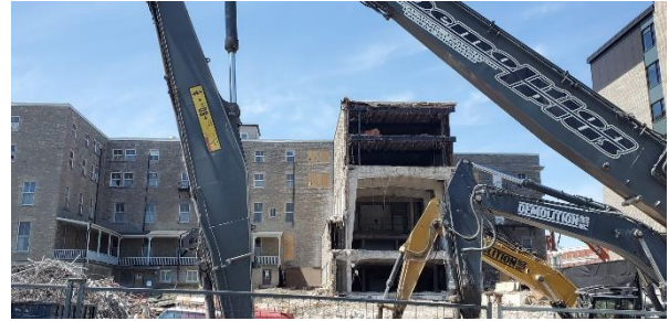
Figura 4. Durante el verano de 2021 se demolió el ala posterior de la iglesia del Edificio Deschatelets, a pesar de estar protegida. Notese la cantidad de toneladas de materiales de desperdicio.
