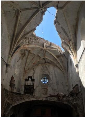
Figura 2. Convento de Huaquechula, Puebla, México. Daños en la bóveda de crucería ocasionados por el sismo de septiembre 2017. La parte superior del campanario fue intervenido, erróneamente, con hormigón armado.
