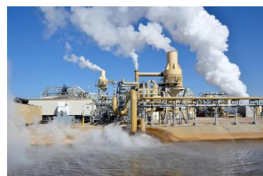
Il·lustració 8 de Piensa en Geotermia. Planta Geotèrmica.
