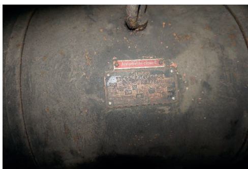
Figura 4: motor Siemens de 30 CV (Foto: MMG).
